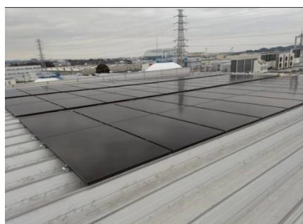
太陽光発電パネル【折板屋根面】
