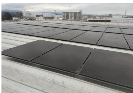
太陽光発電パネル【折板面】
