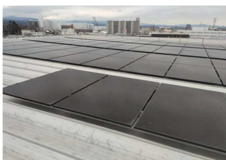
太陽光発電パネル【折板面】
