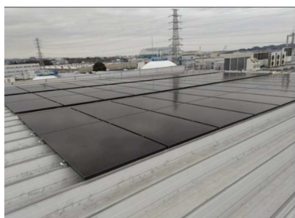
太陽光発電パネル【折板屋根面】
